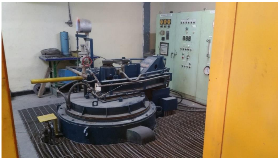
Figure.II.15 : Four de nitruration gazeuse UBE-NACHI, Japan (Usine Algal+ M'Sila)
