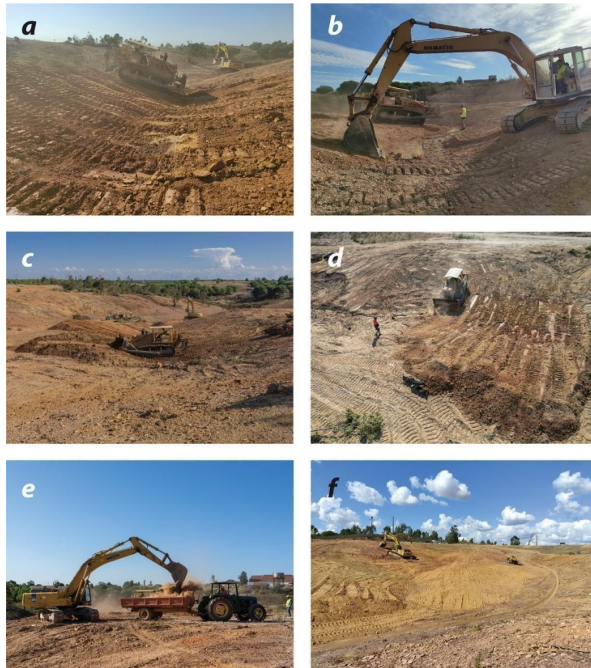
Figure 23- Construction du site de réhabilitation à l'aide des excavateurs et des bulldozers (Sánchez Donoso et al., 2023).
