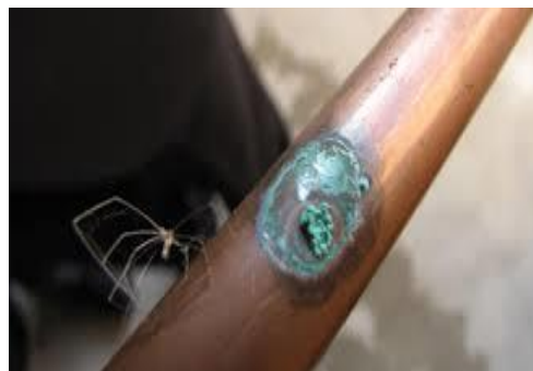
Figure I.6. Corrosion par piqure dans un tube de cuivre [32].
