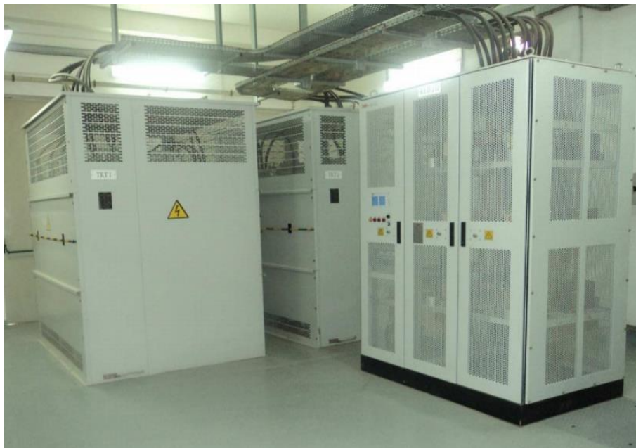
Figure II.9. Photo réelle du transformateur Tramway Constantine.
