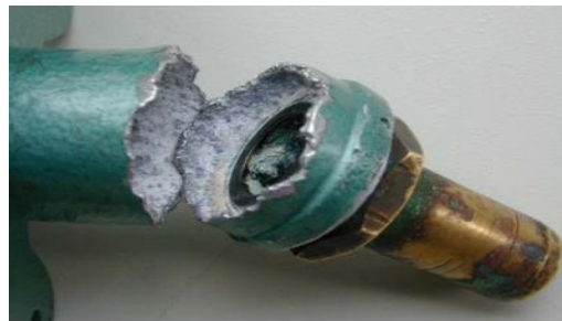
Figure I.5. Corrosion galvanique entre laiton et cuivre [31].
