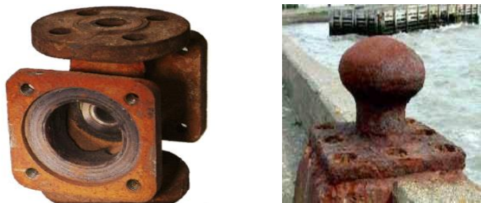
Figure I.3. Effet de la corrosion généralisée. [29]
