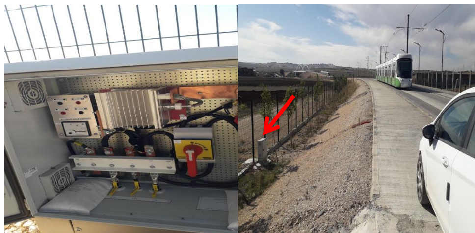
Figure I.31. Appareil du drainage à proximité de la voie ferrée (Constantine 2021).
