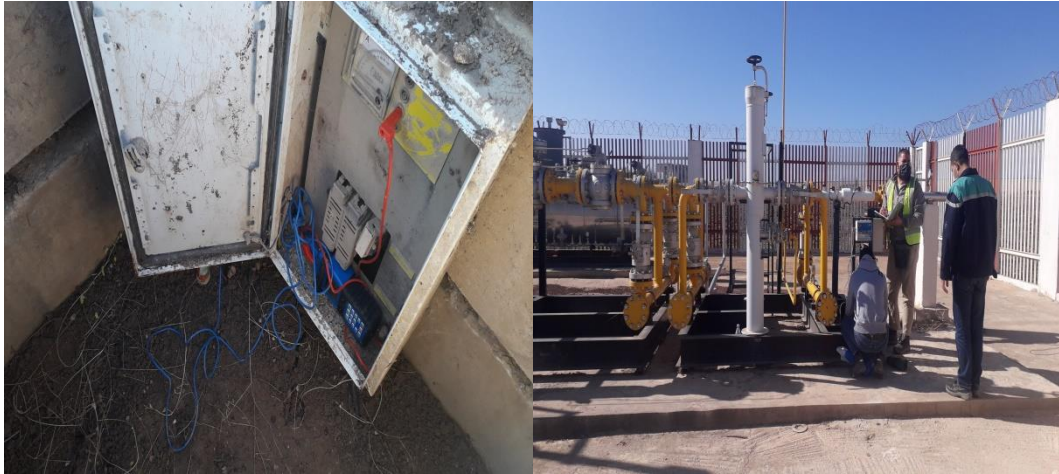
Figure III.11. Enregistrement des paramètres électriques.
