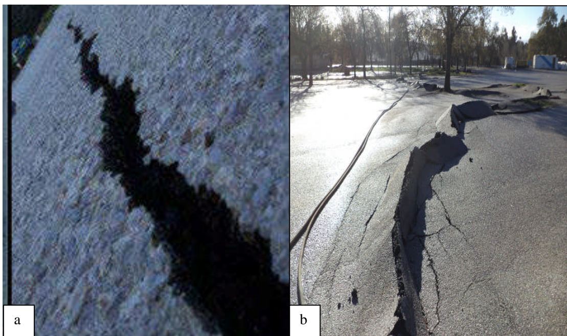
Figure V.27 : les fissures de tension et de compression apparues en surface à l'endroit de l'effondrement du tube gauche du tunnel : a : fissure de tension, b : fissure de compression
