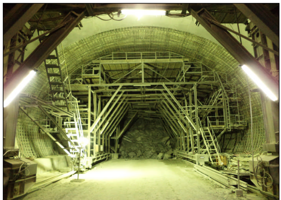
Figure IV.5 : l'effondrement au niveau du tube gauche
