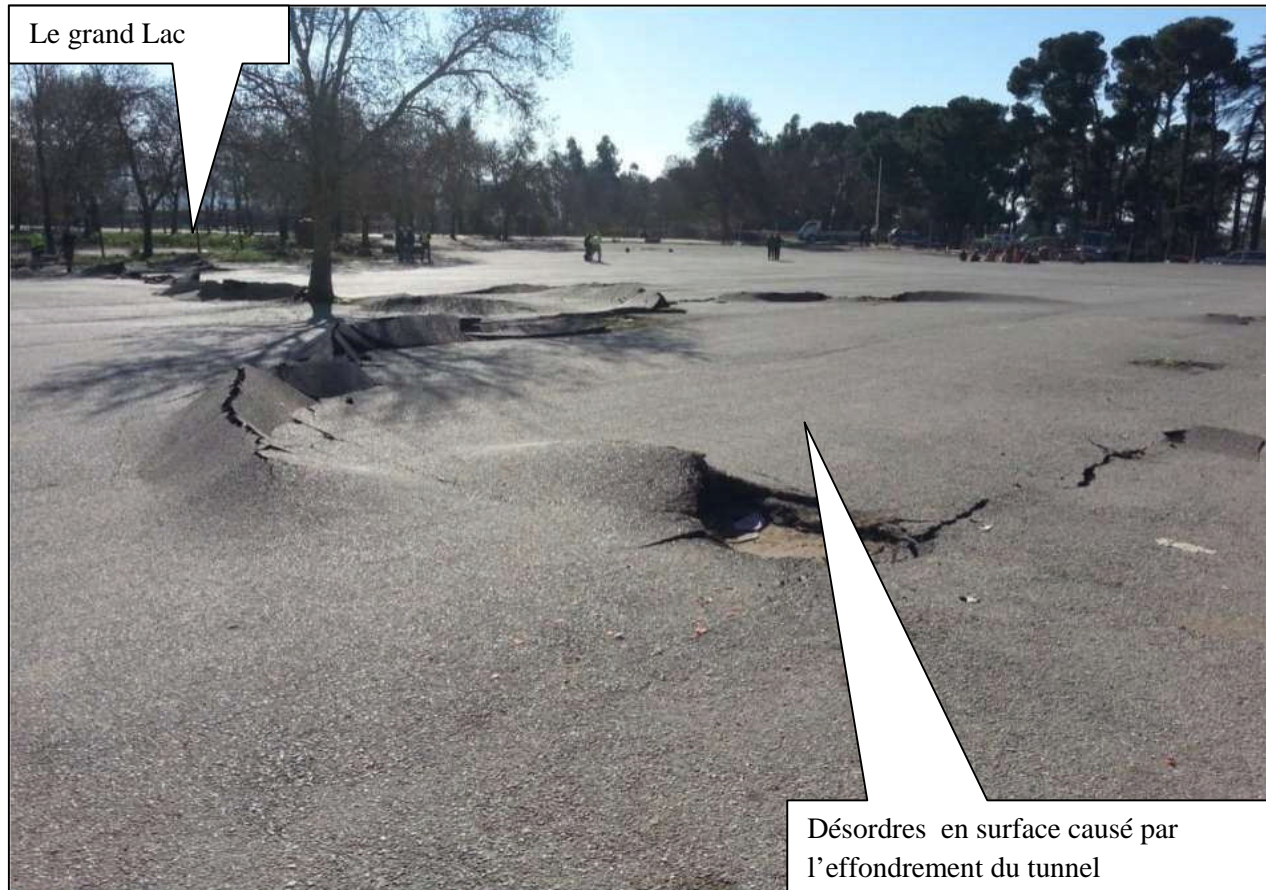
Figure V.26 : les désordres apparus en surface à l'endroit de l'effondrement du tunnel près du grand lac
