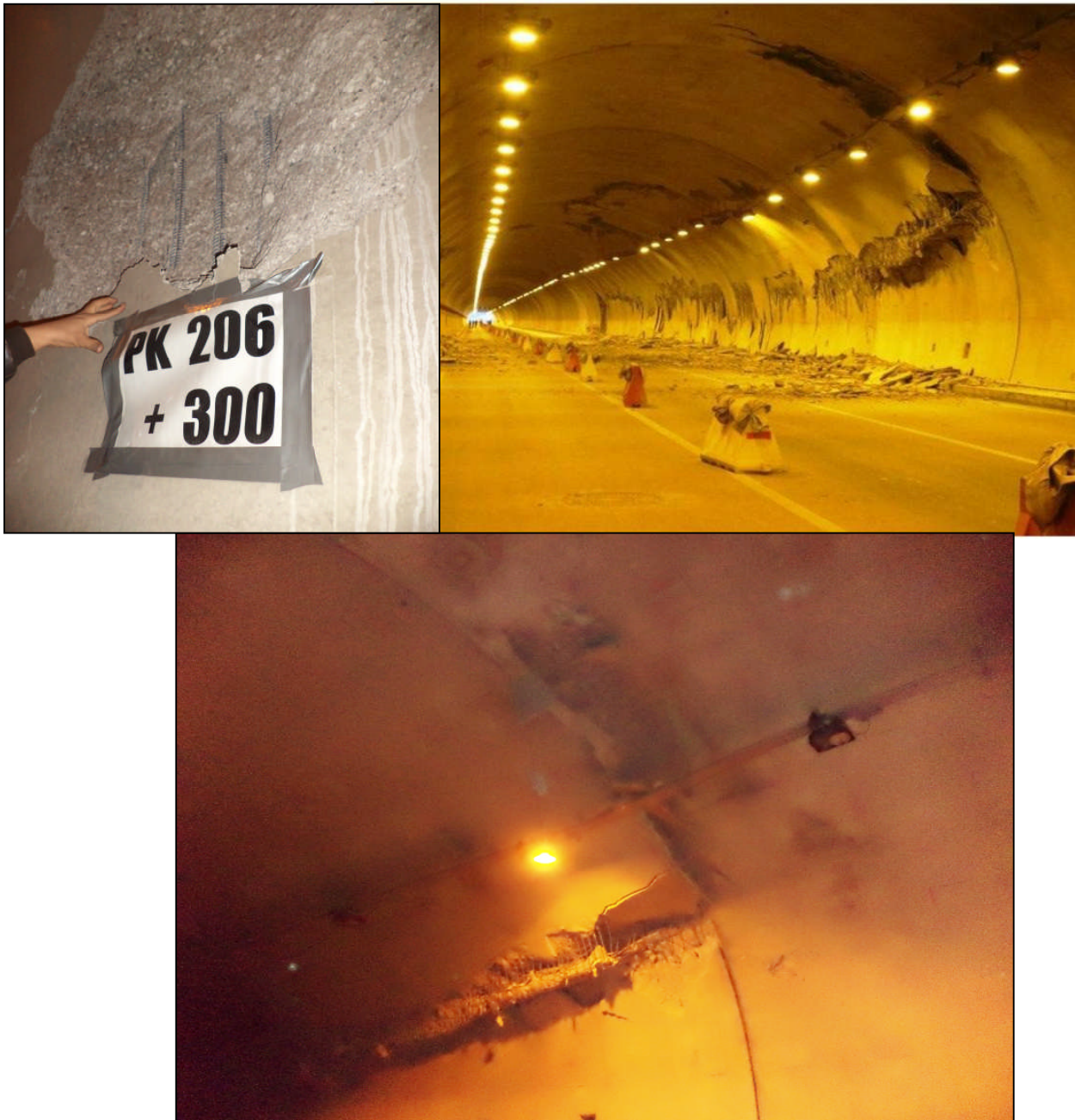
Figure IV.6 : les dégâts causés par l'effondrement au niveau du tube (Est) droit
