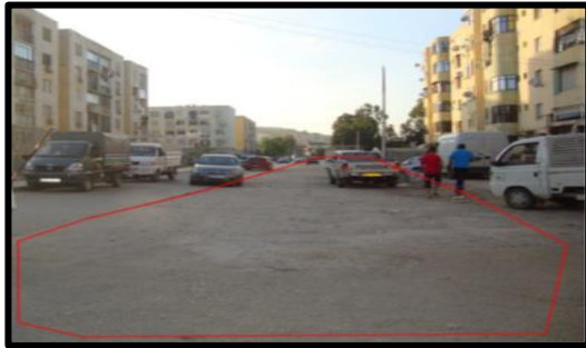
Axe reliant Bd. H. Boumediene au Stade du 20 août (chaussée déformée)
