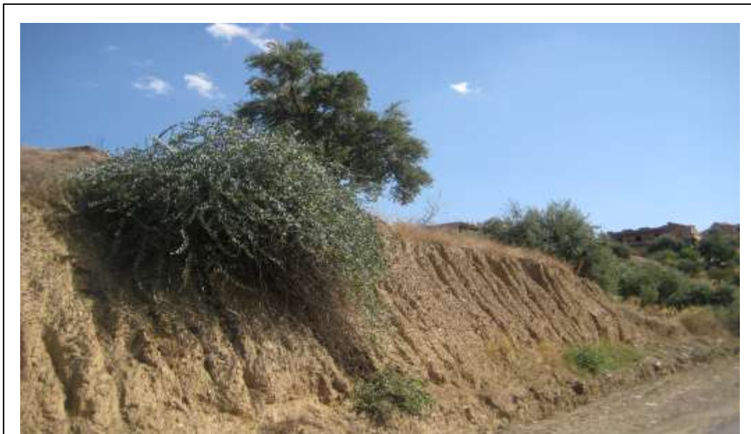
Fig. 17. Câprier fixant le talus extrêmement raviné suite à la réalisation d'une piste de désenclavement. (Ighil Ali, Akbou)
