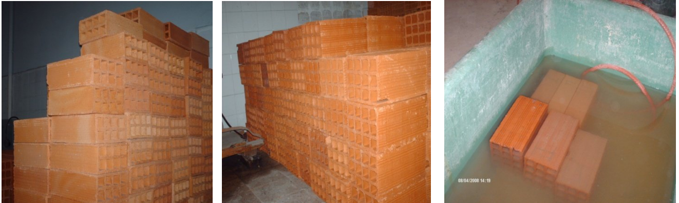
Fig. IV.48 unités de brique 8 et 12 trous choisie avec soin et émergé avant la réalisation des panneaux de maçonnerie.
