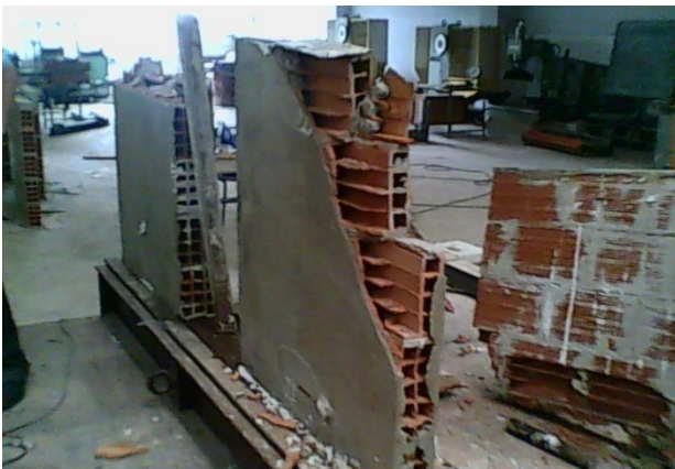
Fig. IV.74 Rupture mur de l'essai n°4 face jauge.
