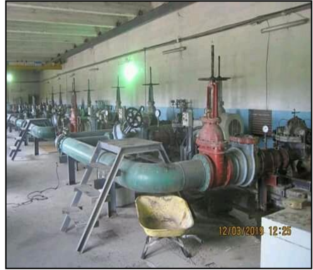
Fig. 60 : Salle des pompes.
