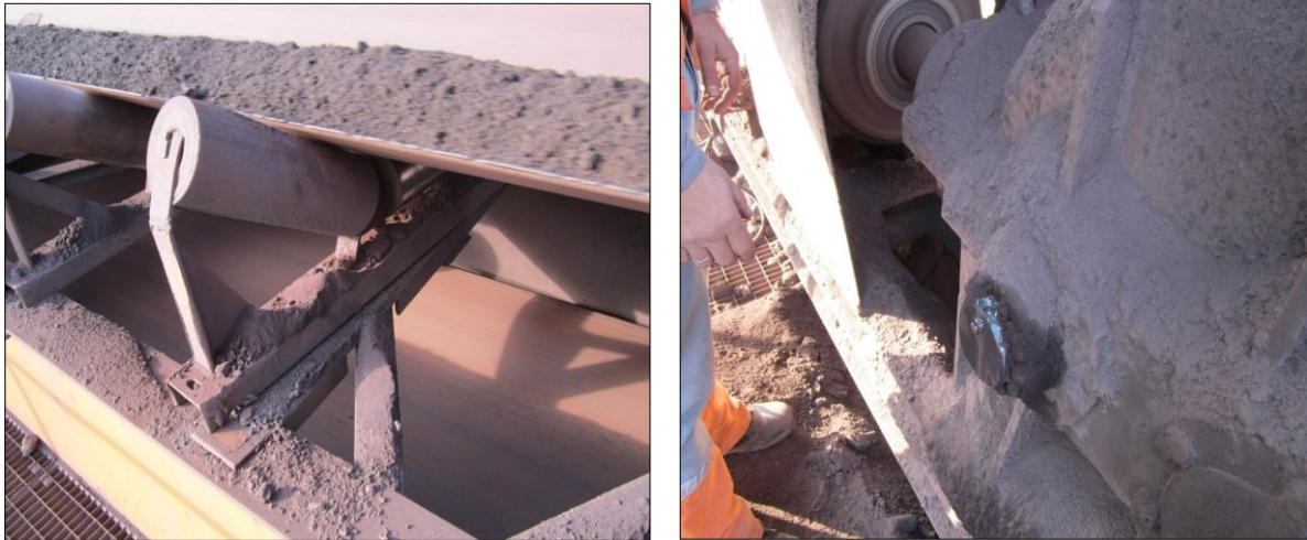
Figure III.14 : Impact des poussières sur les installations (Accouplement et Convoyeur)
