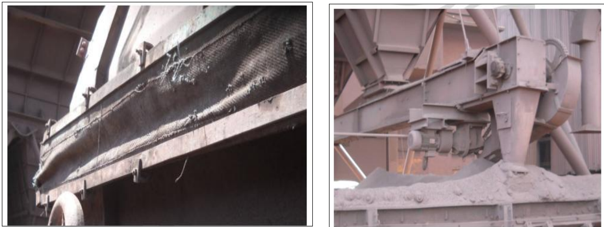
Figure III.15 : Les joints d'expansion et bande transporteuse détériorés - ESP3
