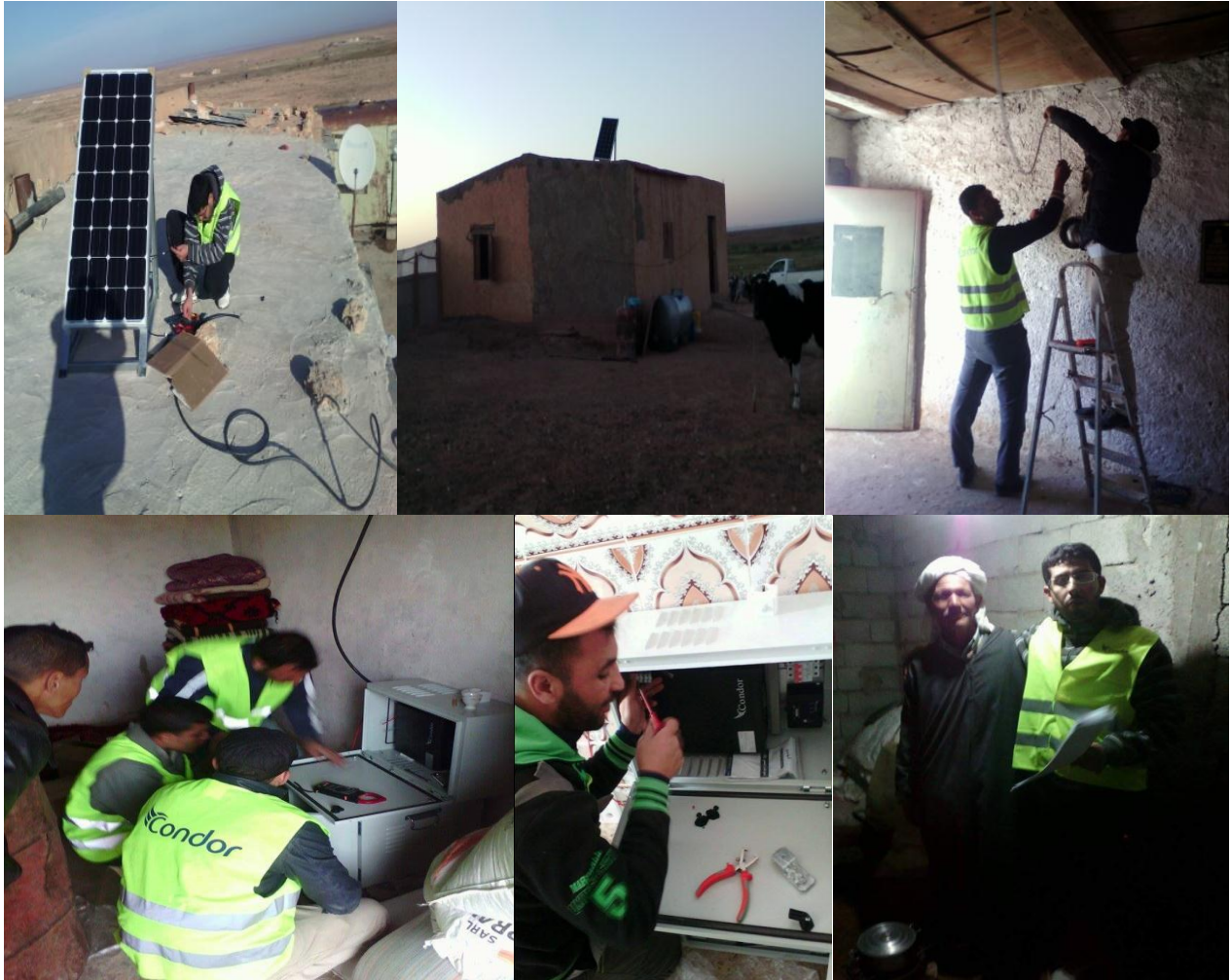
Figure V. 33 Vue d'ensemble du système photovoltaïque installé.
