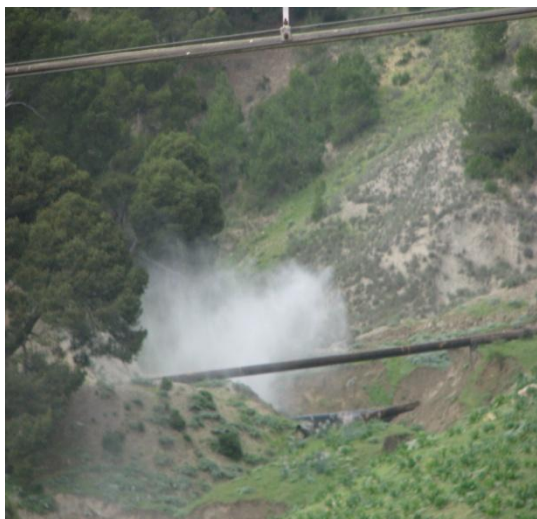
Photo 4.1. Fuite sur la conduite d'adduction de la nappe de Taoura (Souk-Ahras)
