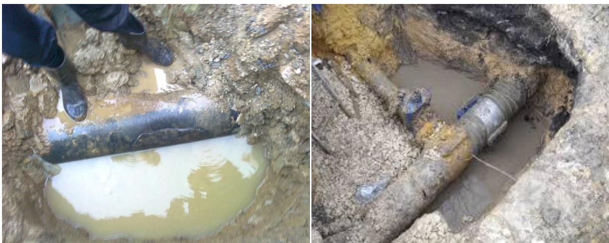
Photo 4.3. Fuite d'eau sur réseau de distribution
