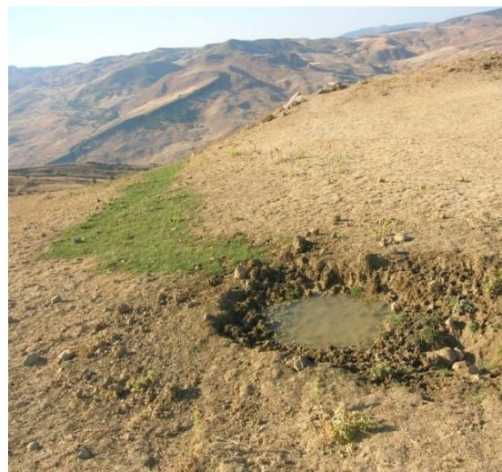
Photo 4.2. Fuite sur la conduite d'adduction DEKMA-SNIC (Souk-Ahras)
