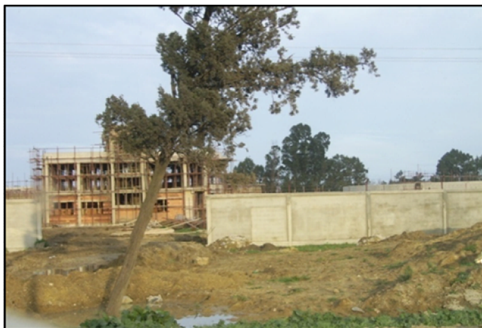
Photo 49 Le projet de station d'épuration des eaux usées industrielles dans la zone de l'EL ALLALICK
