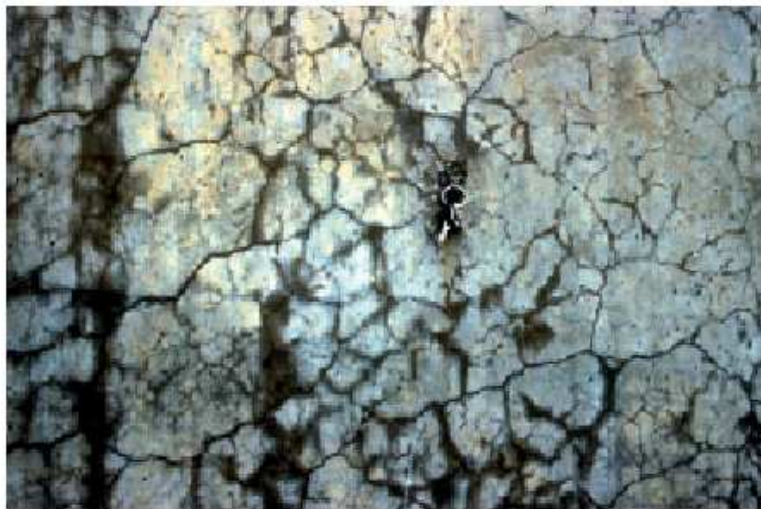
Figure 1.6 : Endommagements par fissuration multidirectionnelle à mailles [2].
