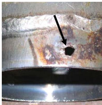
Figure I.2 Corrosion par piqûres
