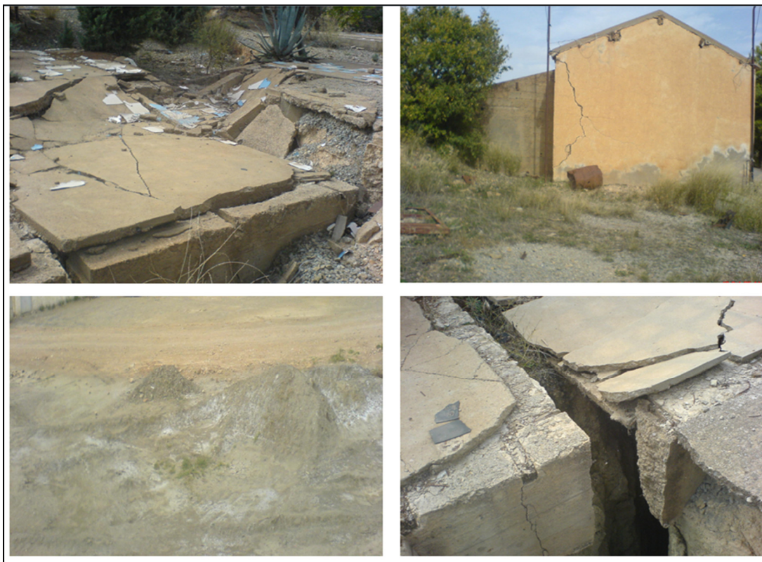
Figure I.5 : Observation de fractures et de fissures au-dessus des anciens travaux miniers, Mine Kherzet Youssef (BOUKELLOUL.M.L, 2007).
