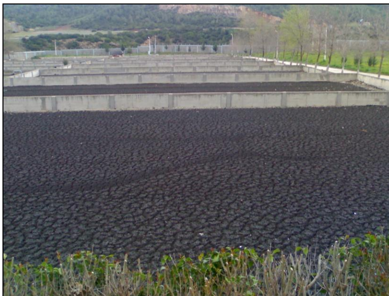
Figure N°26 : Lits de séchage des boues [23].
