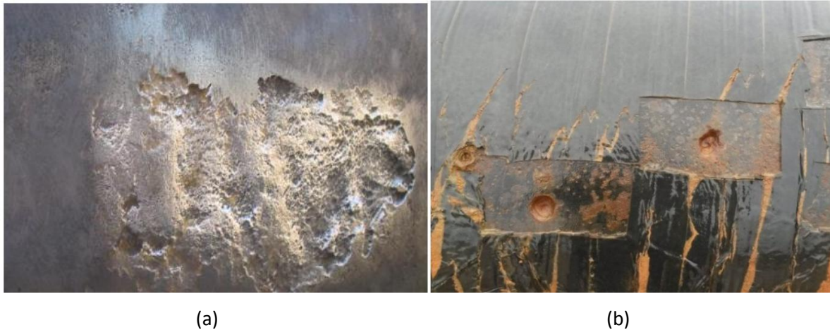
Figure 1.4 : Corrosion externe d'un pipeline de transport de gaz, (a) (Sonatrach- HASSI R'mel, 2015) et (b) Centre de compression N°5 (CC5), Kenanda-RELEZAN, (TRC, 2016)
