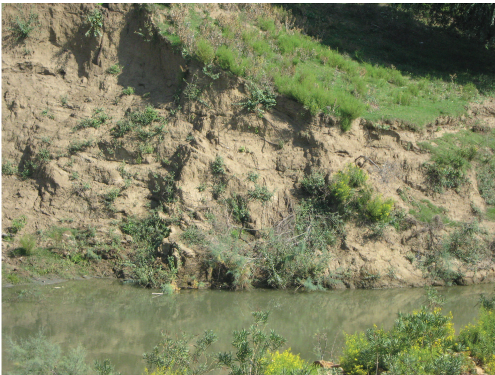
Photo 2. Processus du sapement de berge (photo en haut) et du glissement de terrain résultant de ce processus (photo en bas) dans l'Oued Kébir Est.
