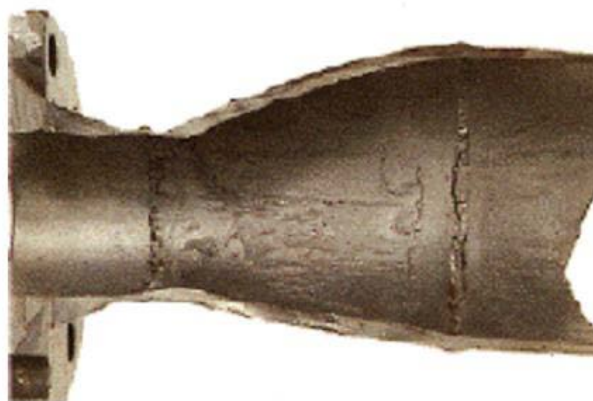
Figure I.10: Corrosion-érosion dans une zone turbulente [54].
