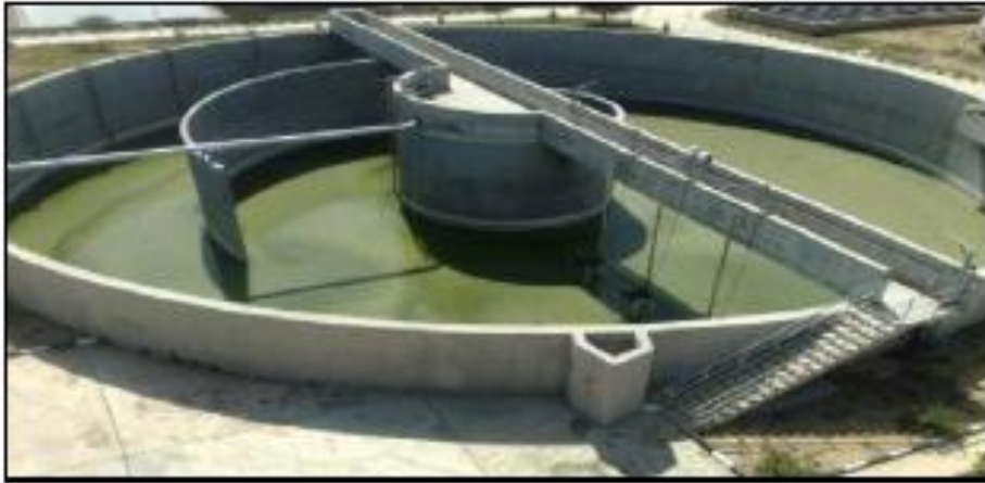
Photo 7. Bassin d'aération de la station d'épuration de Sedrata
