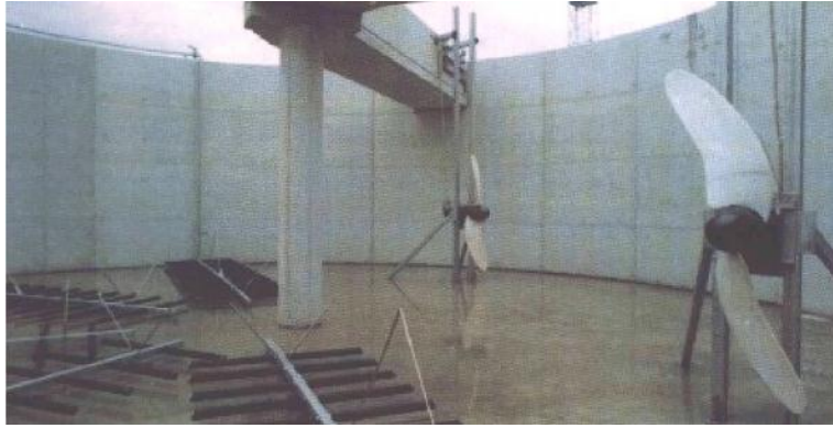
Photo 5 : Chenal d'aération - Insufflation d'air + agitation
