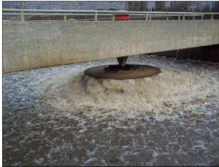
Photo 01 : Turbine de surface à vitesse lente (immersion insuffisante)
