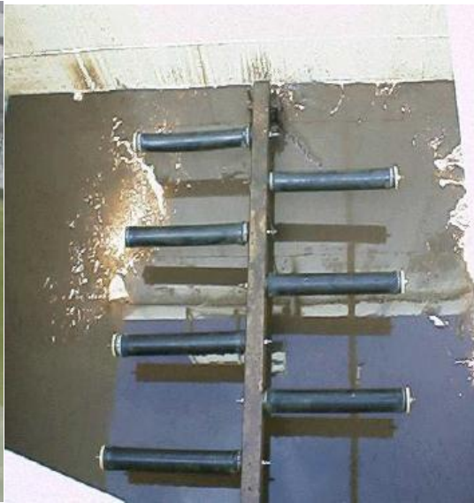
Photo 4 : Rampes immergées de Diffuseurs fines bulles
