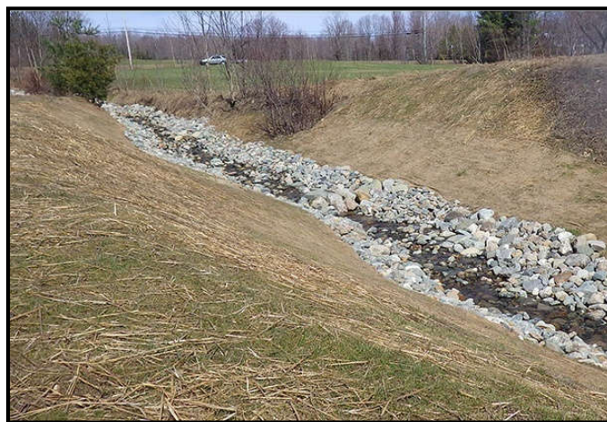
Figure V.3 Aménagement du lit d'un cours d'eau (source: photo prise par l'entreprise Hydro-Aménagement, Alger)
