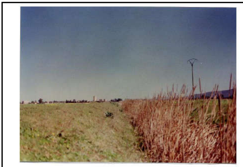
Figure II.6 Canal du système de drainage de la plaine Bouteldja envahi par les roseaux empêchant la bonne évacuation de l'eau ( source : photo prise par l'auteur en 2016)
