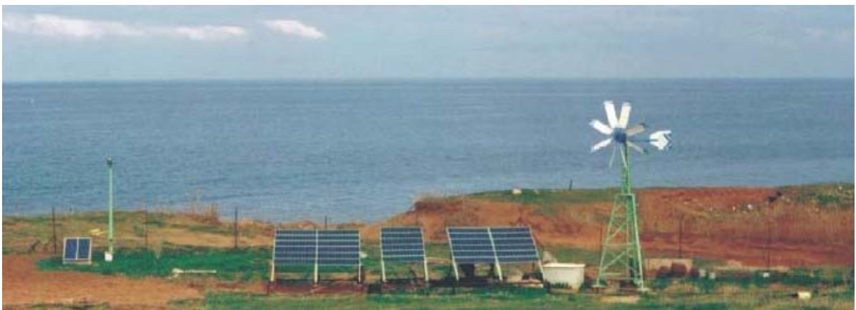
Fig. I.18 : Système hybride pour le pompage de l'eau Bou-Ismaïl- Tipaza [18]
