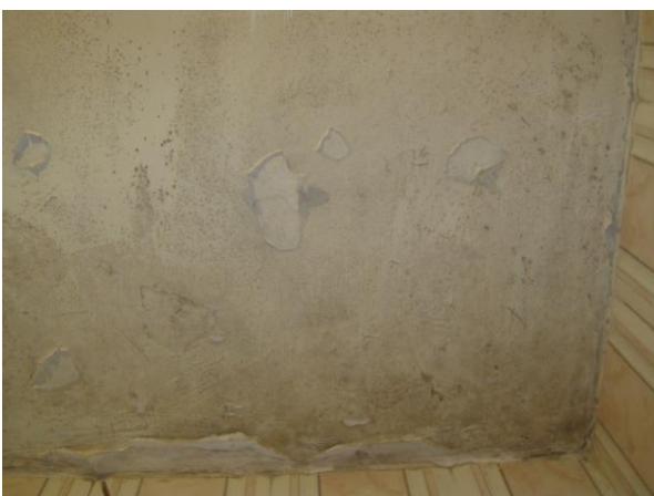
Photo 5 : Problème d'humidité avec taches de moisissures dans la salle de bain (habitat n°5)
