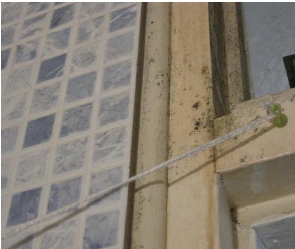
Photo 3 : Taches de moisissures dans la salle de bain (habitat n°1)
