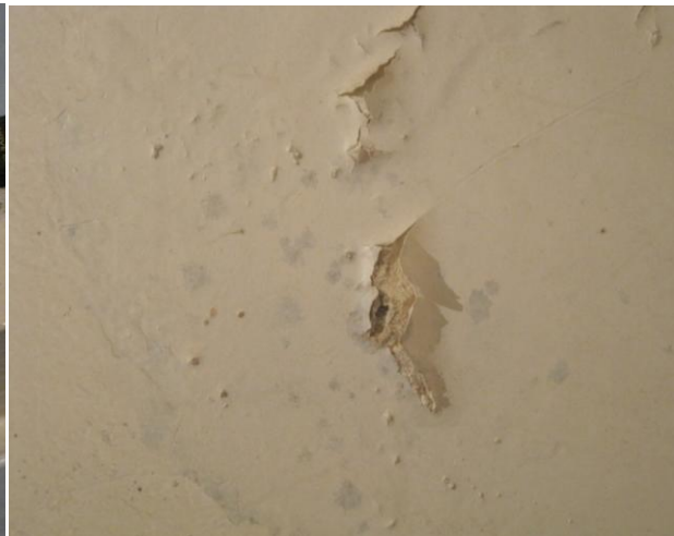
Photo 4 : Problème d'humidité (habitat n°6)
