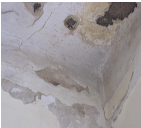
Photos 2 : Problème d'infiltration d'eau (habitat n°2)
