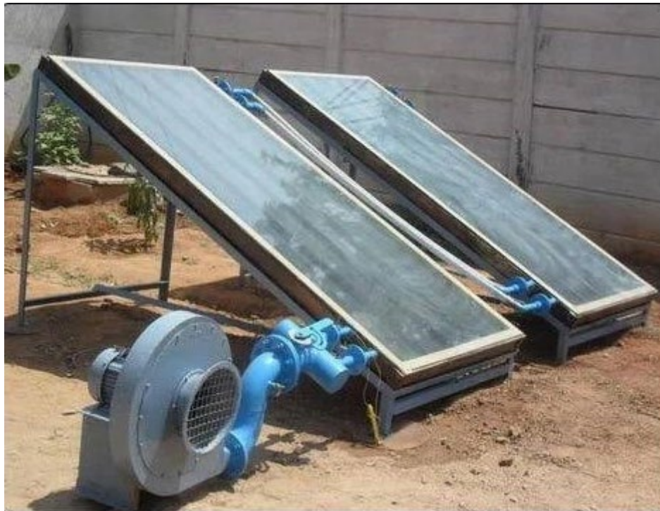
Fig. IV-1. Deux Capteurs héliothermiques en série avec ventilateur de soufflage d'air
