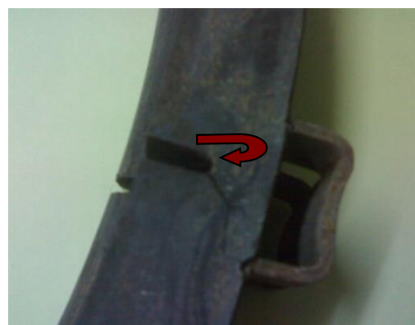
Figure 51 : semelle fissurée à partir de l'entaille
