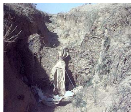
Photo.17 : Seuil en grillage métallique (Algérie)
