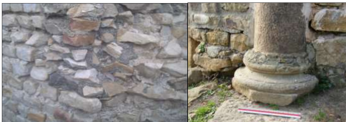
Photo 46: Mauvaises interventions sur les pierres d'un mur, Photo 45: Mauvaises interventions sur une colonne, Source : Auteur Octobre 2010 Source : Auteur, Octobre 2010
