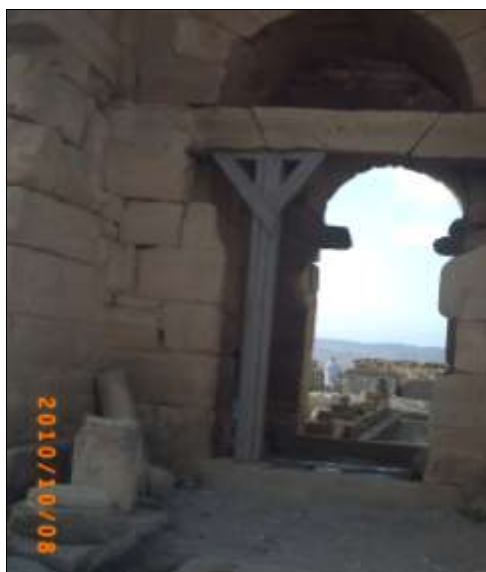
Photo 47: Dégradation due au mauvais choix des matériaux pour consolidation, Source : Auteur, octobre 2010.
