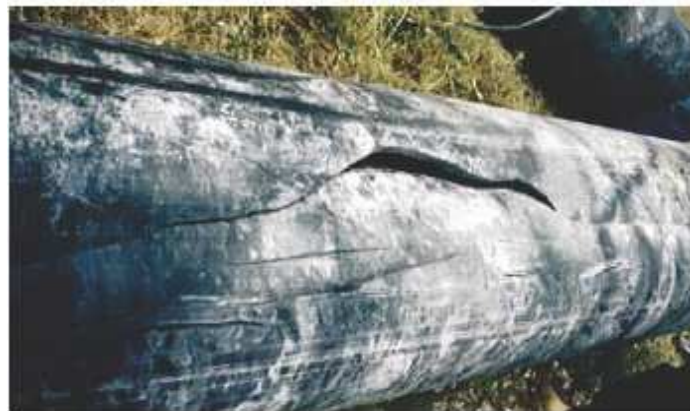
Figure IV.2 : Résultats de l'interaction des tubes HDPE avec les fluides transportés et l'environnement externe, rupture d'un tube d'eau (grand diamètre) [66].
