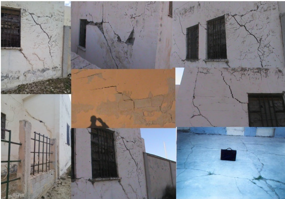
Fig.34 Endommagements observés sur les constructions provoqués par gonflement des sols.
