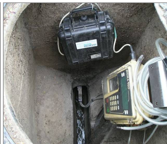
Installation du Débitmètre Bulle à Bulle dans un regard
