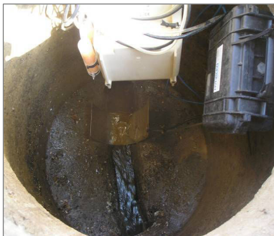
Installation Bulle à Bulle + doppler dans un regard
