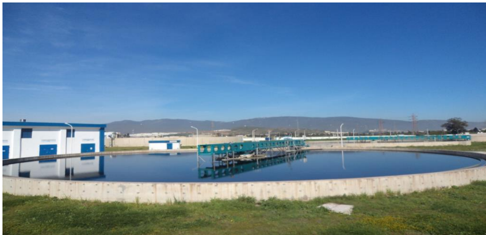
Figure n°14. Décanteur primaire (STEP Annaba).
