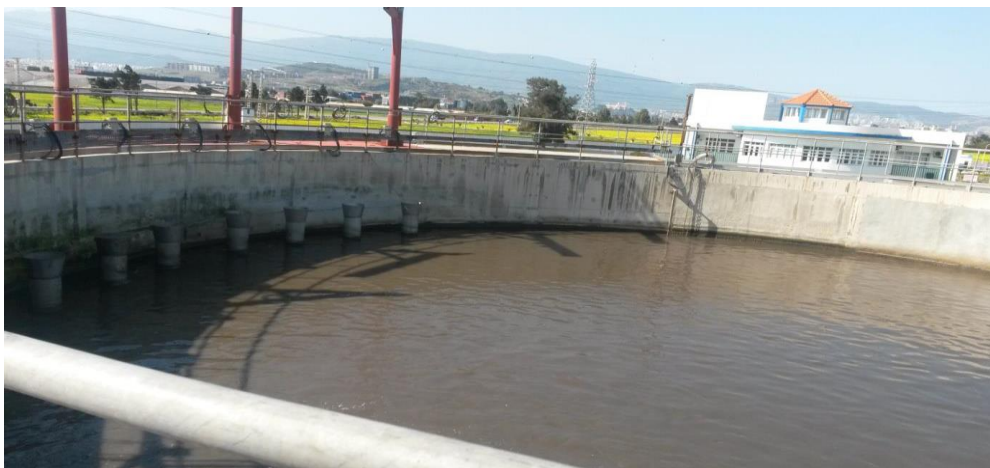
Figure n°16. Bassin de Relevage intermédiaire (Station d'El-Allélick, Annaba).
