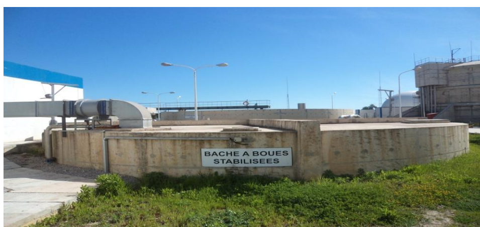
Figure n°22. Bache à Boues Stabilisées. (STEP Annaba).
