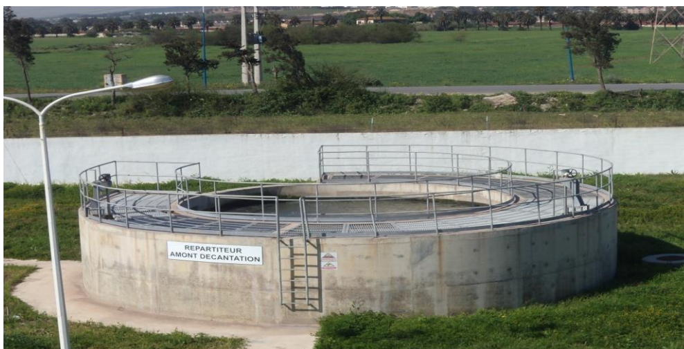
Figure n°15. Amont décanteur (STEP Annaba).
