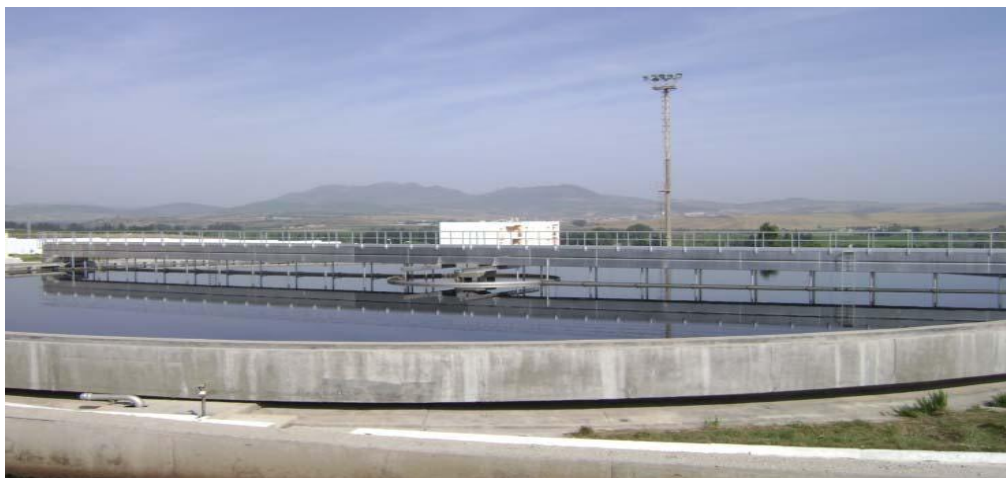
Figure n°19. Clarificateur (STEP Annaba).
