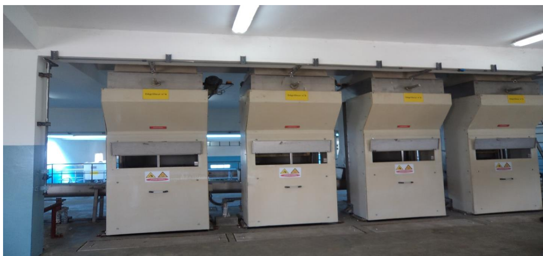
Figure n°12. Dégrillage (STEP Annaba).
