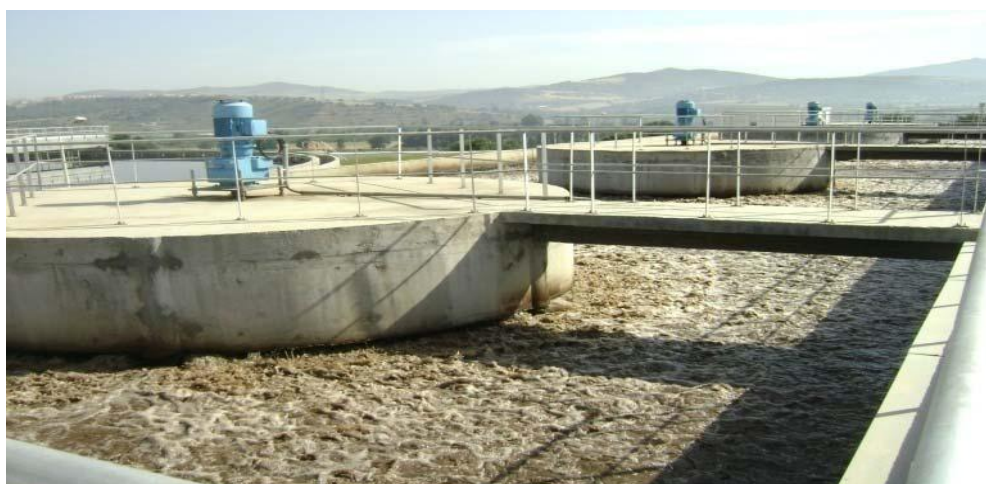
Figure n°17. Bassin de traitement biologique (STEP Annaba).
