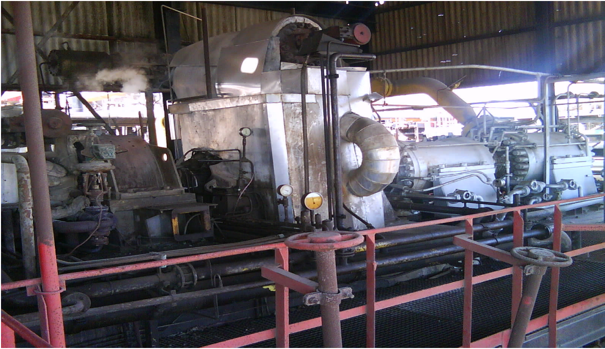
Figure 4.3 : COMPRESSEUR 103 J – compresseur HP/BP - turbine HP/BP -
