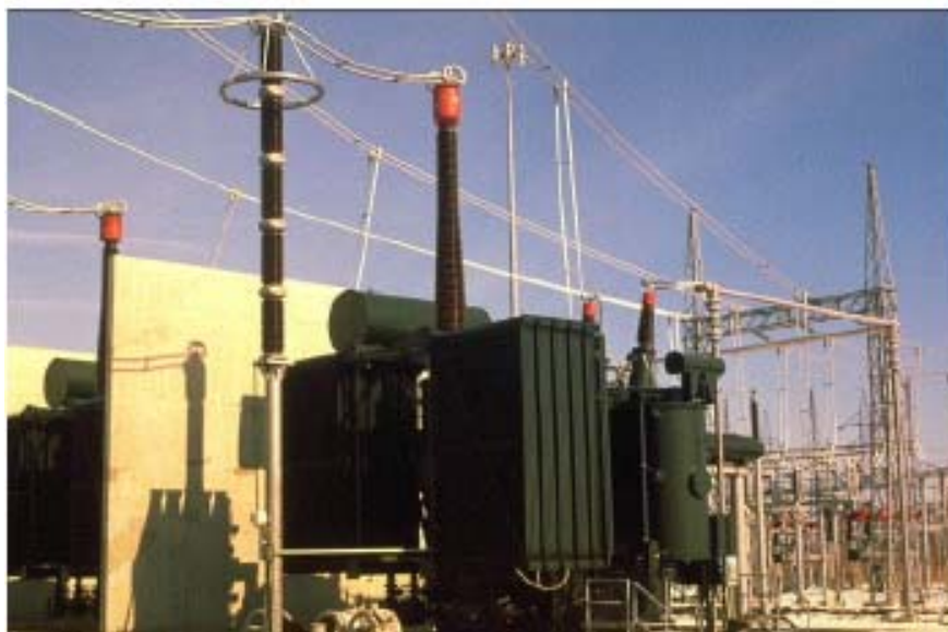
Figure 6-4: image d'un poste de transformation HT avec parafoudre
