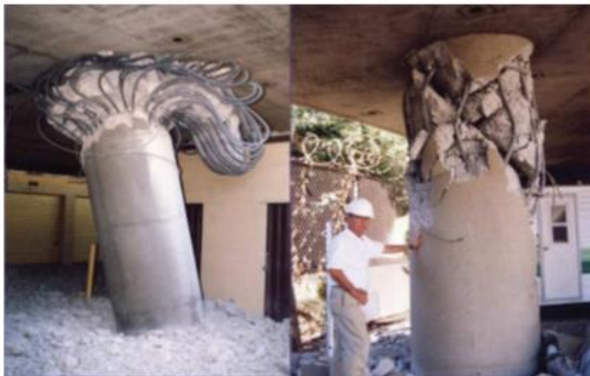
FIGURE II. 18 Rupture d'une colonne en béton armé lors d'un séisme
