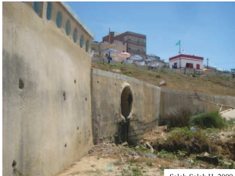
Figure n°20 : Rejets liquides dans la mer
