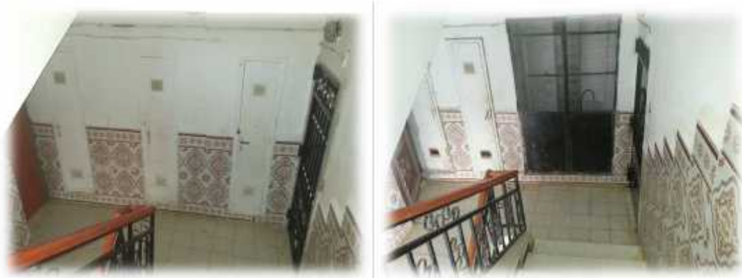
Figure 43: les placards techniques au niveau du bâtiment 2 ème cas d'étude.
