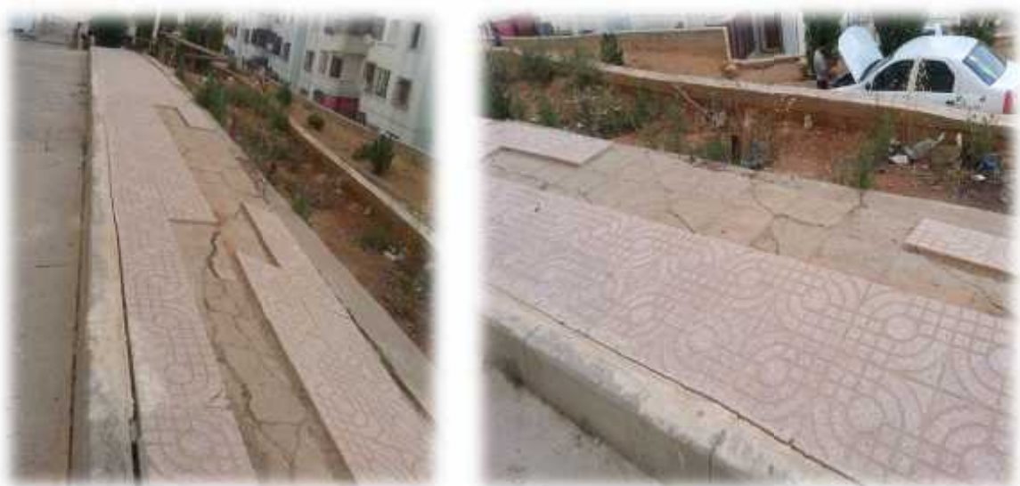
Figure 52: Les glissements et les fissures au niveau des trottoirs.
