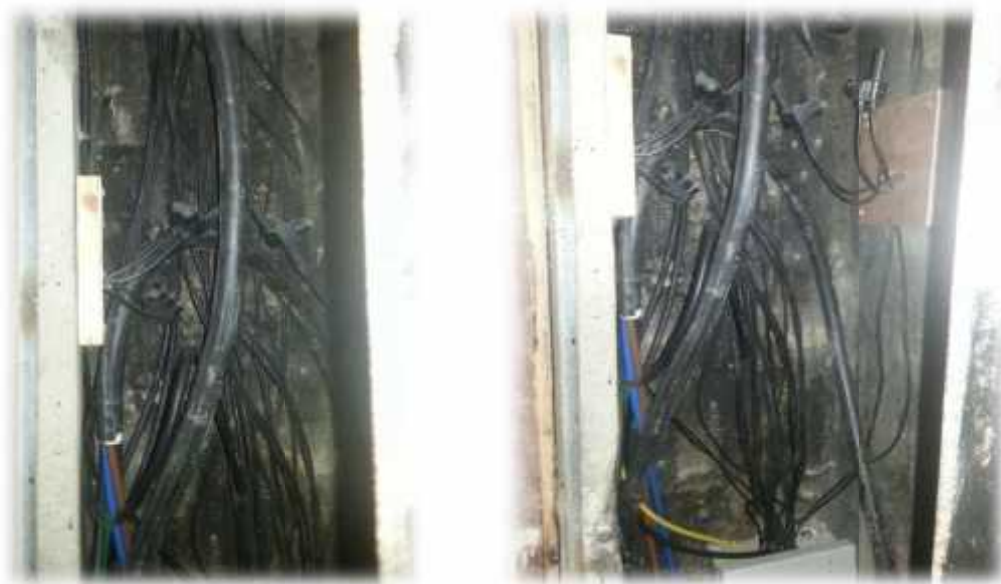
Figure 27: Etincelle électrique au niveau d'un placard technique.
