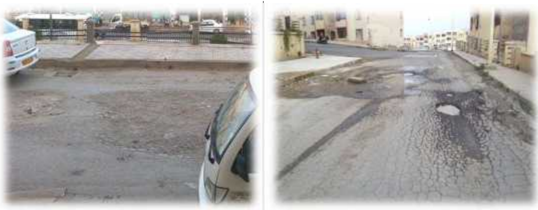
Figure 34 : L'état des routes dans le 2 ème cas d'étude.
