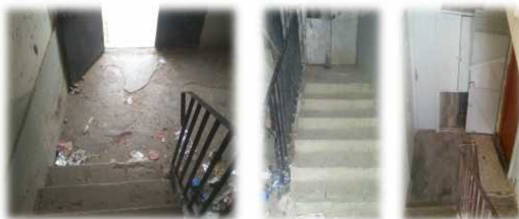
Figure 26: les cages d'escalier inconvenables.
