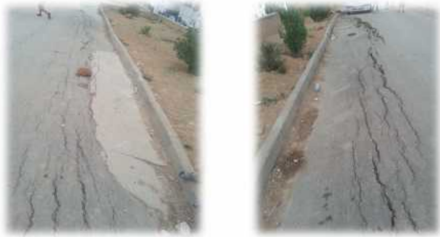
Figure 53: La défaillance des routes.
