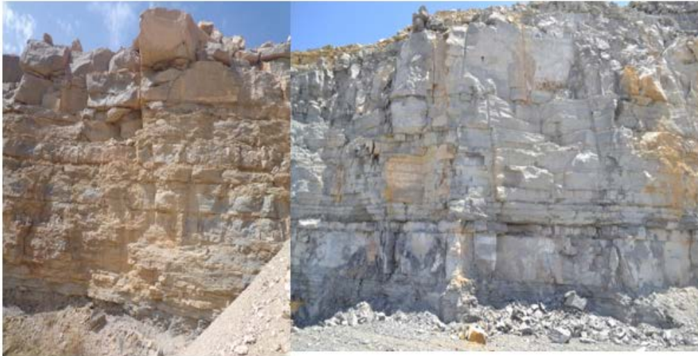
Figure. I.5. Joints de stratification dans un calcaire (effet arrière sur un mur de pré-découpage), carrière Chouf-Amar 2016.
