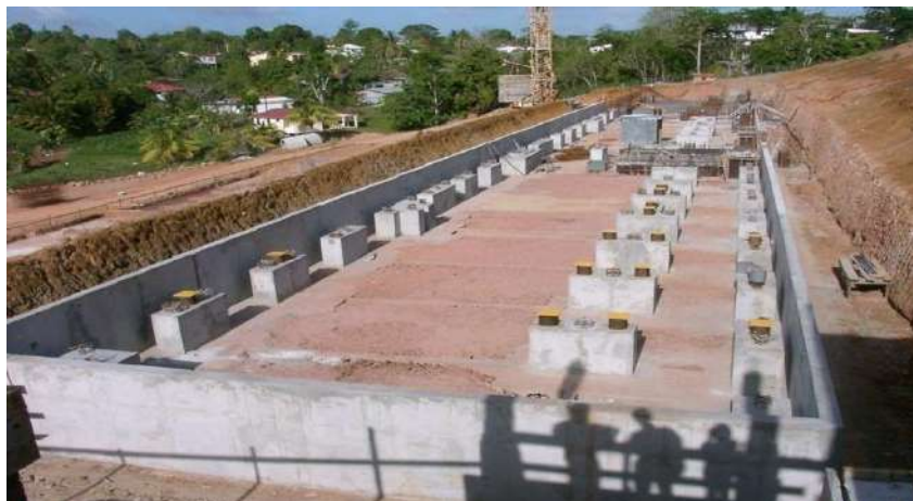
Figure 7.12 Isolateurs sur les massifs de fondation [24]
