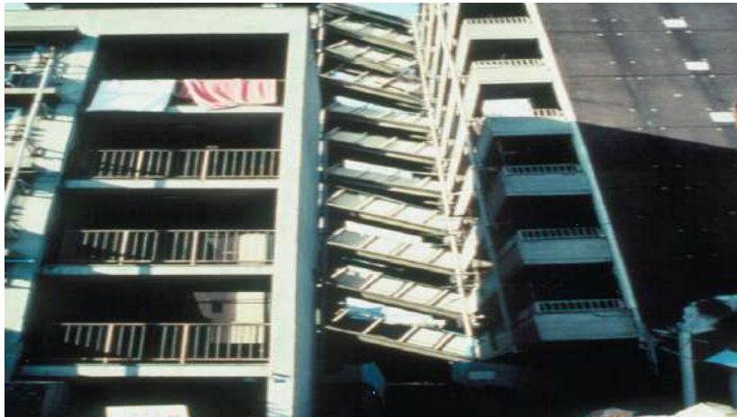
Figure 3.23 Destruction de passerelles dûe d'une part à des oscillations différentielles et, d'autre part aux dommages subis par le bâtiment de droite (séisme de Kobé, Japon, 17.1.1995) [17]
