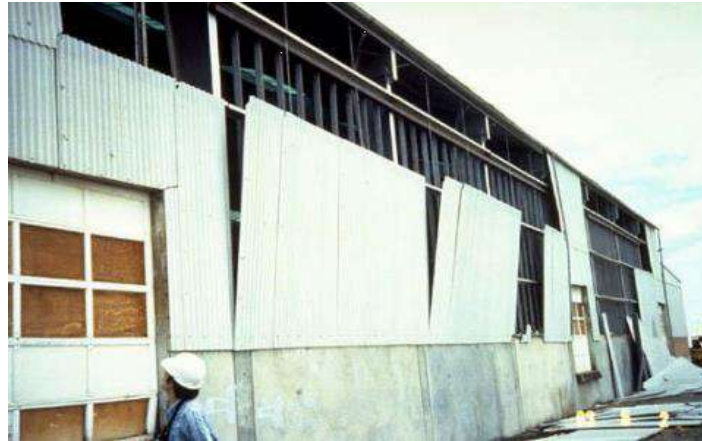
Figure 6.9 Chute des bardages mal fixés [24]
