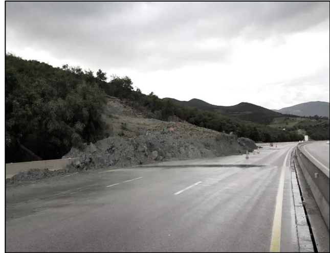
Photo 7. Glissement de terrain sur l'autoroute Est-Ouest entre Azzaba et El Harouch. (Affoun Ikhlef, 25 /12/ 2019)
