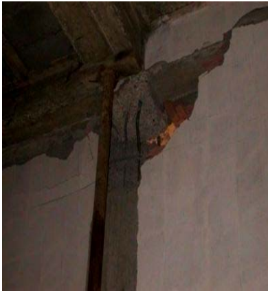
(3) Formation de rotule plastique au niveau d'un poteau Alger Séisme du 21 mai 2003
