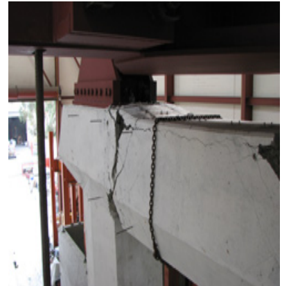
(5) Formation de rotule plastique au niveau d'une poutre
