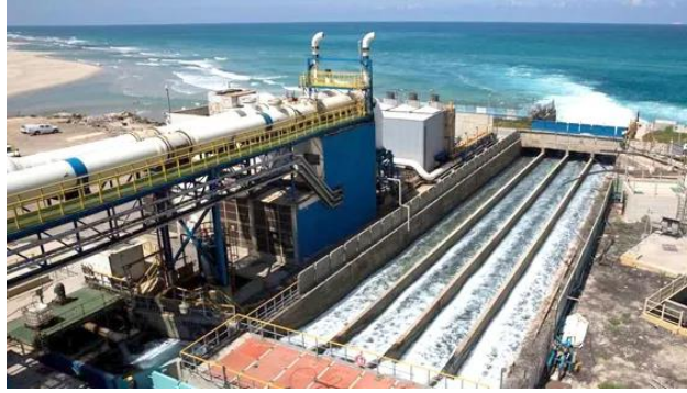
Photo II.5. Station de dessalement de Draouche
