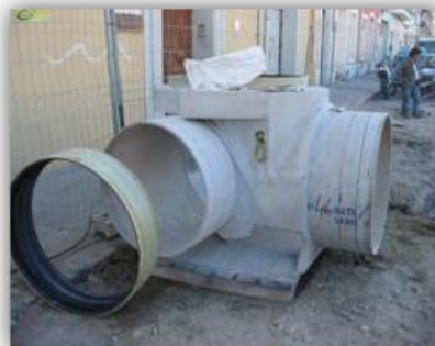
Regard pour tuyaux PRV – Chantier de Sète
