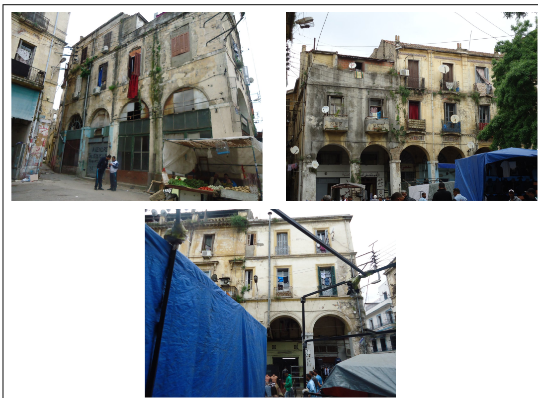
Figure 21: L'état de détérioration avancé des façades de la Place (source : Zediri Nadia, avril 2012)
