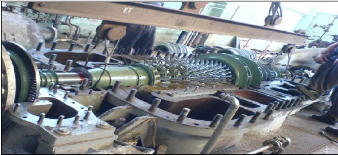
Figure (IV -2) : Photographie du compresseur [21]
