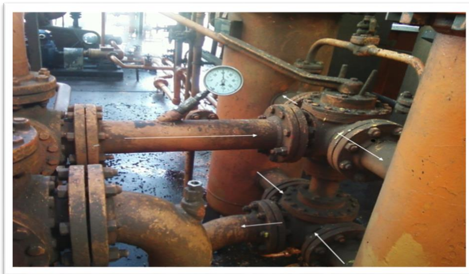
Figure 19: Mano mètre pour mesurer la pression au niveau de la pompe de graissage
