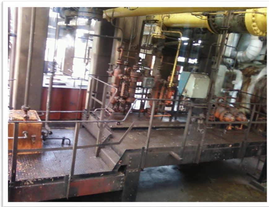
Figure 24: évacuation des gaz d'huile d'étanchéité
