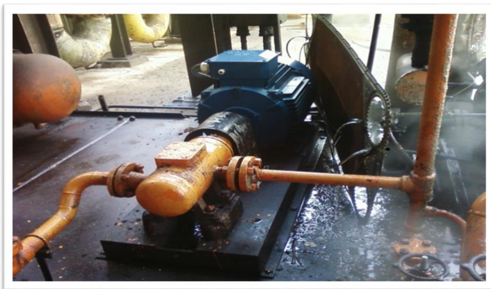
Figure 20 : Les conduites d'aspiration d'une moto pompe d'huile d'étanchéité
