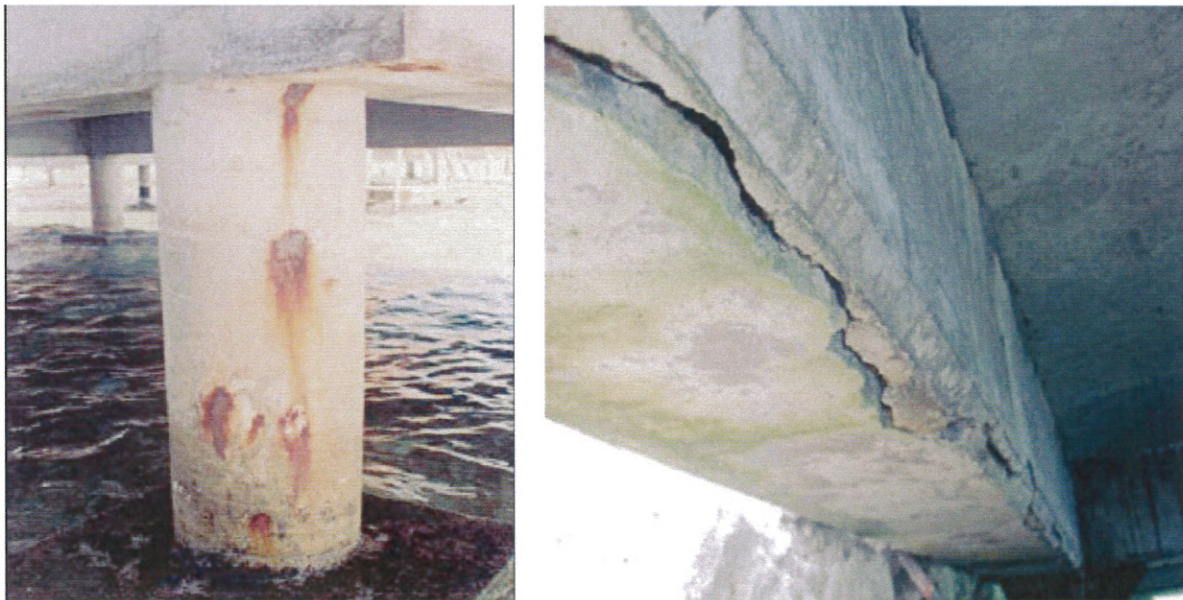
Figure I.2: L'EFFET DES MILIEUX AGRESSIFS SUR LE BETON
